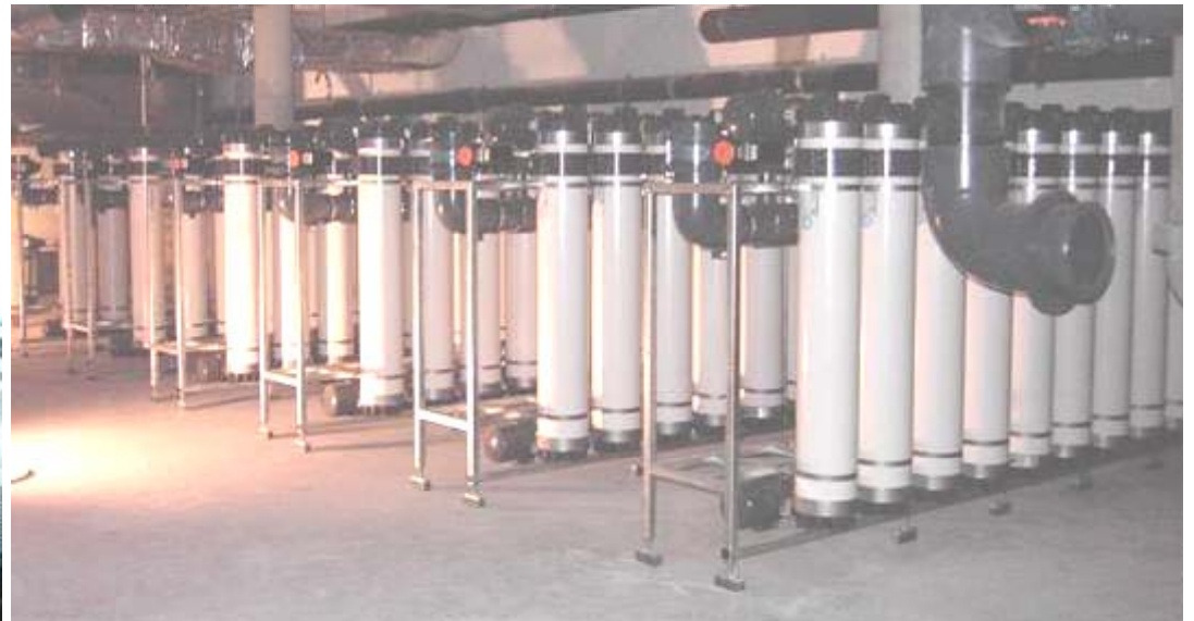
Bad Aibling - 90 modules
